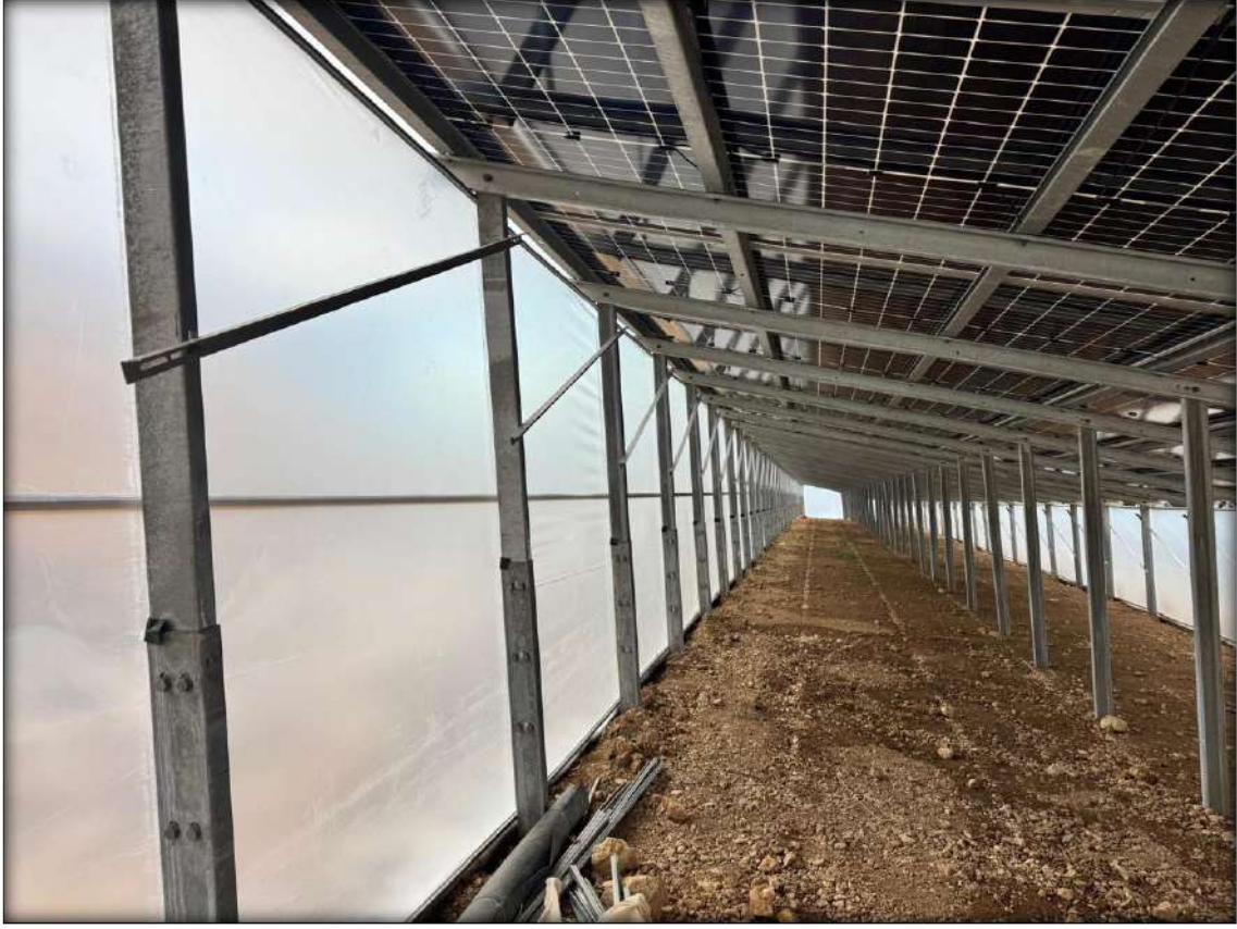
Şekil 1. Bulanık TarımGES Tesisine Ait Görüntü
