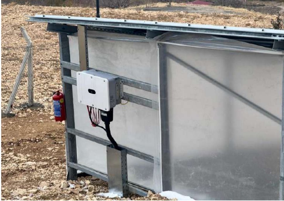
Şekil 2. Bulanık TarımGES Tesisine Ait Görüntü
